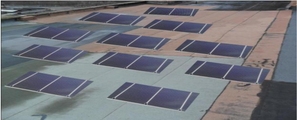
Рис. 7.4.4 Зовнішній вигляд сонячної батареї для обігріву будівлі
